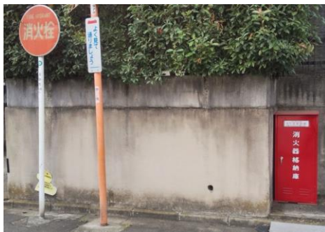
第1号消火設備
