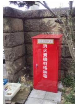
第2号消火設備
